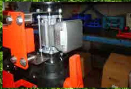
Tank fill meter
